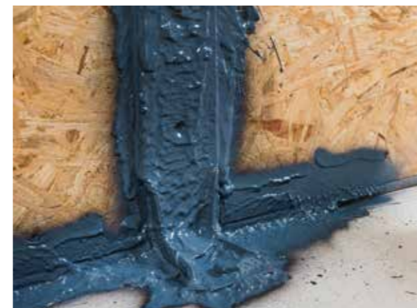
Houtskeletbouw wanden aansluiten op betonnen vloer Luchtdichte overgang tussen plaatmateriaal op basis van hout (bijv. OSB) en bijv. betonnen platen. Complexe vormen (bijv. bevestigingsmiddelen, zoals hoekprofielen) kunnen gewoon worden overgespoten. Langdurige werking conform DIN EN 13984 getest en goedgekeurd.
