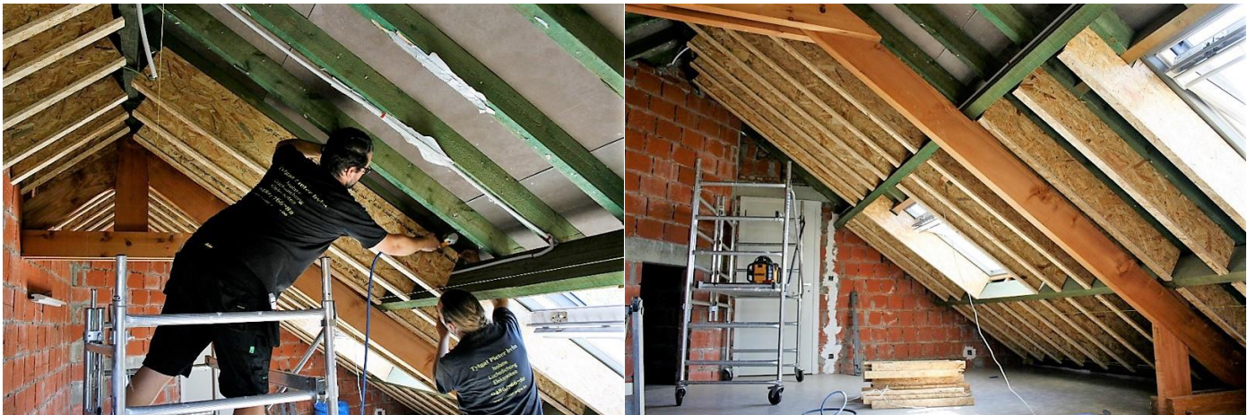
Figure 6 : Exécution d'un chantier d'épaississement de toiture avec iQ3-profil, réalisé par Tytgat Pieter bvba.
